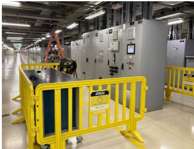
Foto 52: Barreira de segurança durante a manutenção do painel elétrico
