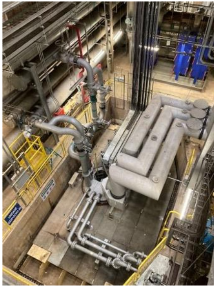
Foto 49: Conexões elétricas acima do nível do gerador
