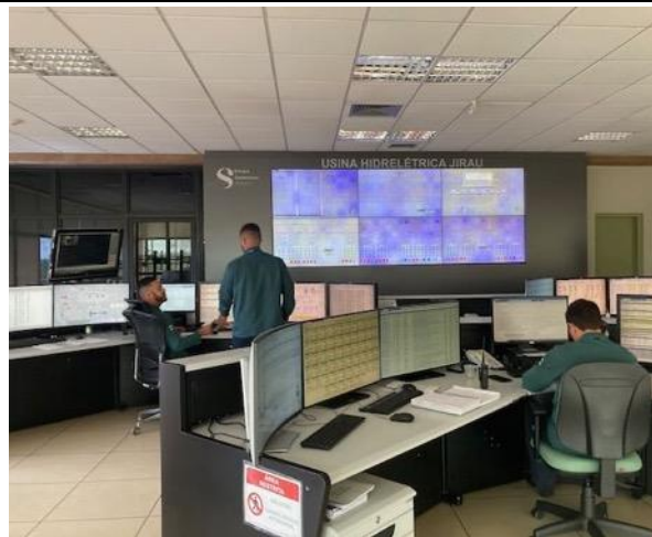
Foto 47: Sala de controle – casa de força da margem direita
