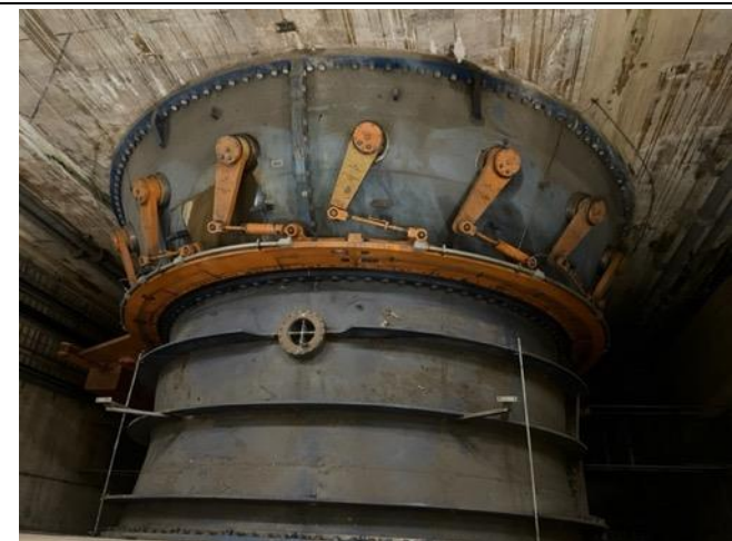
Foto 66: Distribuidor de turbina bulbo, vista de cima
