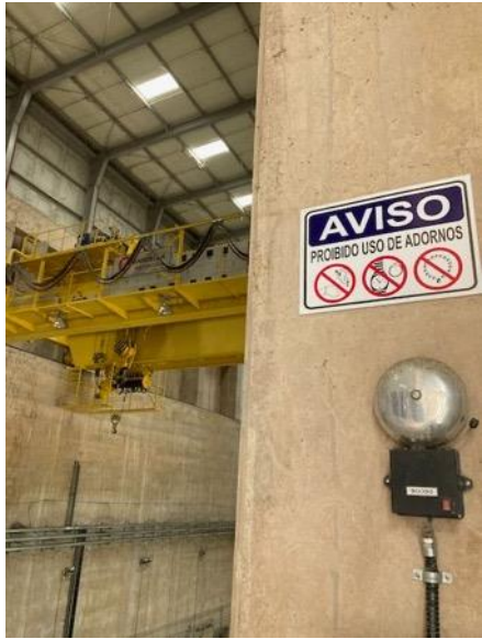
Foto 55: Alarme e sinais de alerta na usina de energia
