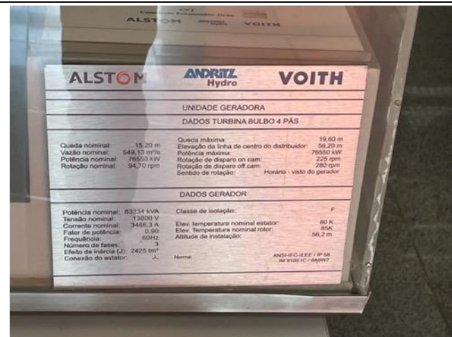
Foto 60: Dados da turbina da usina de energia da margem direita
