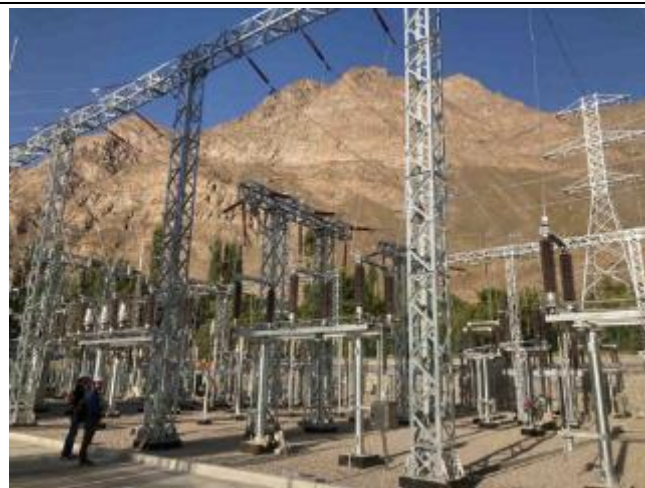
Фотография 77: Новая подстанция 110 кВ на Хорогской ГЭС
