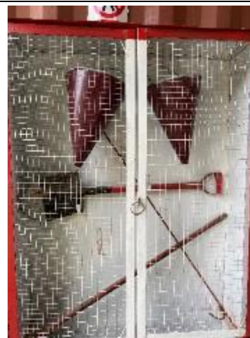
Фотография 89: Средства пожарной безопасности на месте строительства водозабора
