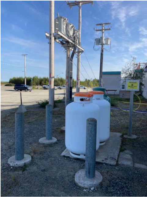
Photo 37 : Barrières de sécurité autour des réservoirs de gaz
