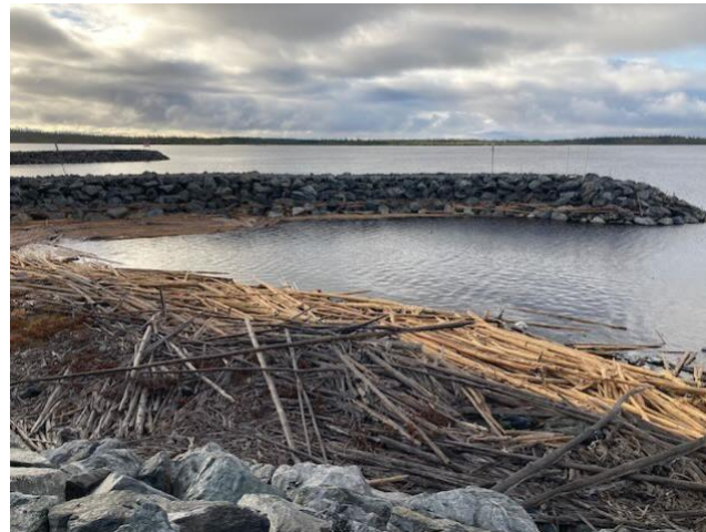
Photo 44 : Débris et panneaux d'avertissement devant l'évacuateur de l'Eastmain-1
