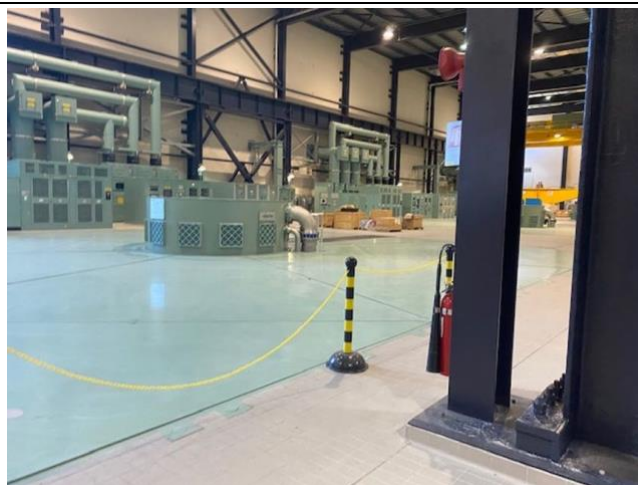
Photo 5 : Intérieur de la centrale de l'Eastmain-1a
