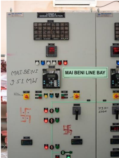
तस्विर ५२: गोदक सबस्टेसन नियन्त्रण कक्षमा रहेको माई बेनी एचपीपीको खाडी
