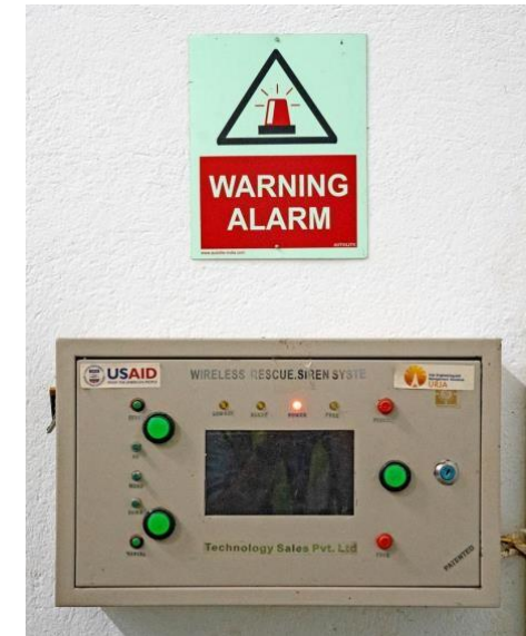
तस्विर ३०: पावरहाउस भित्र अवस्थित यस उपकरणलाई कल गरेर आपतकालीन अलार्म टाढैबाट संचालन गर्न सकिन्छ
